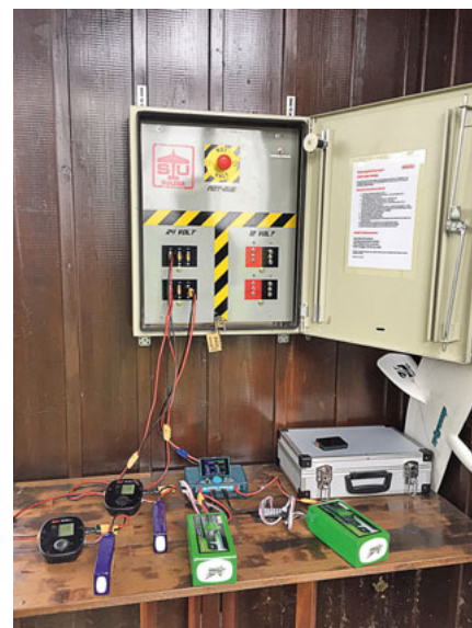
Zugänglicher Teil der Lade-station für die Mitglieder. Wie sich das gehört, ausserhalb des Gebäudes.
