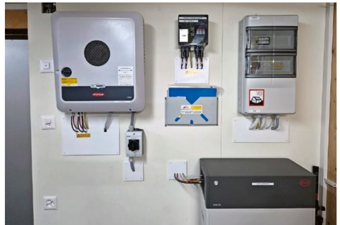
Eine saubere Sache: Alle Geräte sind montiert und alle Kabel verlegt. Auf der linken Seite der Wechselrichter, in der Mitte die Generatoranschlussbox (Blitzschutz), rechts oben die Netzumschaltbox und rechts unten der Speicher mit 10,2 kWh Kapazität.
