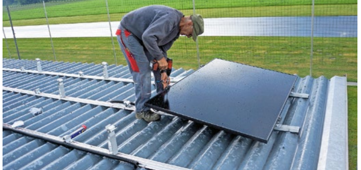
Bei regnerischer Witterung, dafür angenehmen Temperaturen, montiert Josef das erste Panel. Durch das Schienensystem müssen die Panels nur auf die Stützen gelegt, ausgerichtet und mit Pratzen festgespannt werden.
